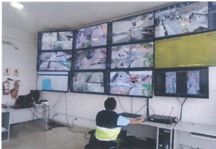
Centro de control de operaciones y telealarma.
